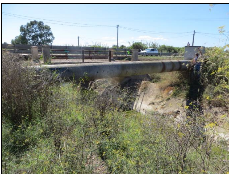
Foto 7) Tubo di attraversamento parallelo al ponte sulla strada comunale Assemmini-Sestu.
